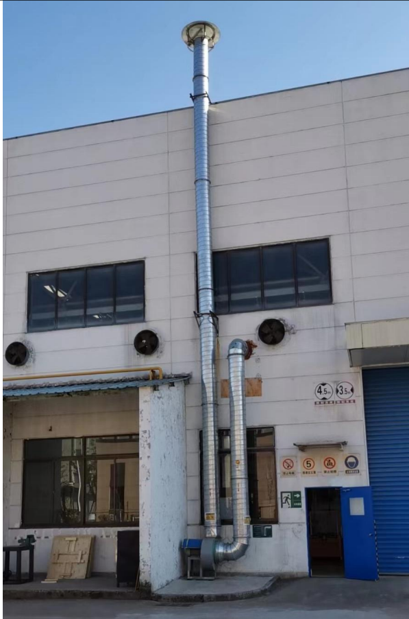
热处理废气排气筒
