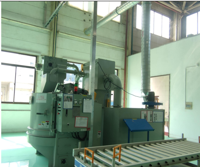
抛丸机及抛丸机除尘系统
